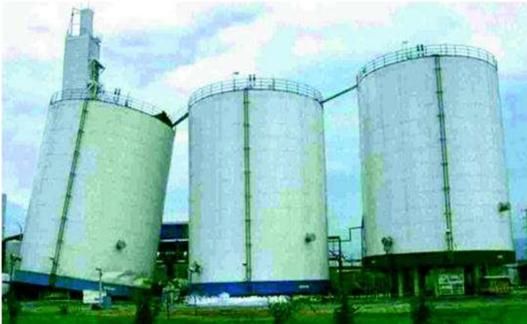
Terremoto in Turchia del 1999 M=7,6 (Izmit)
